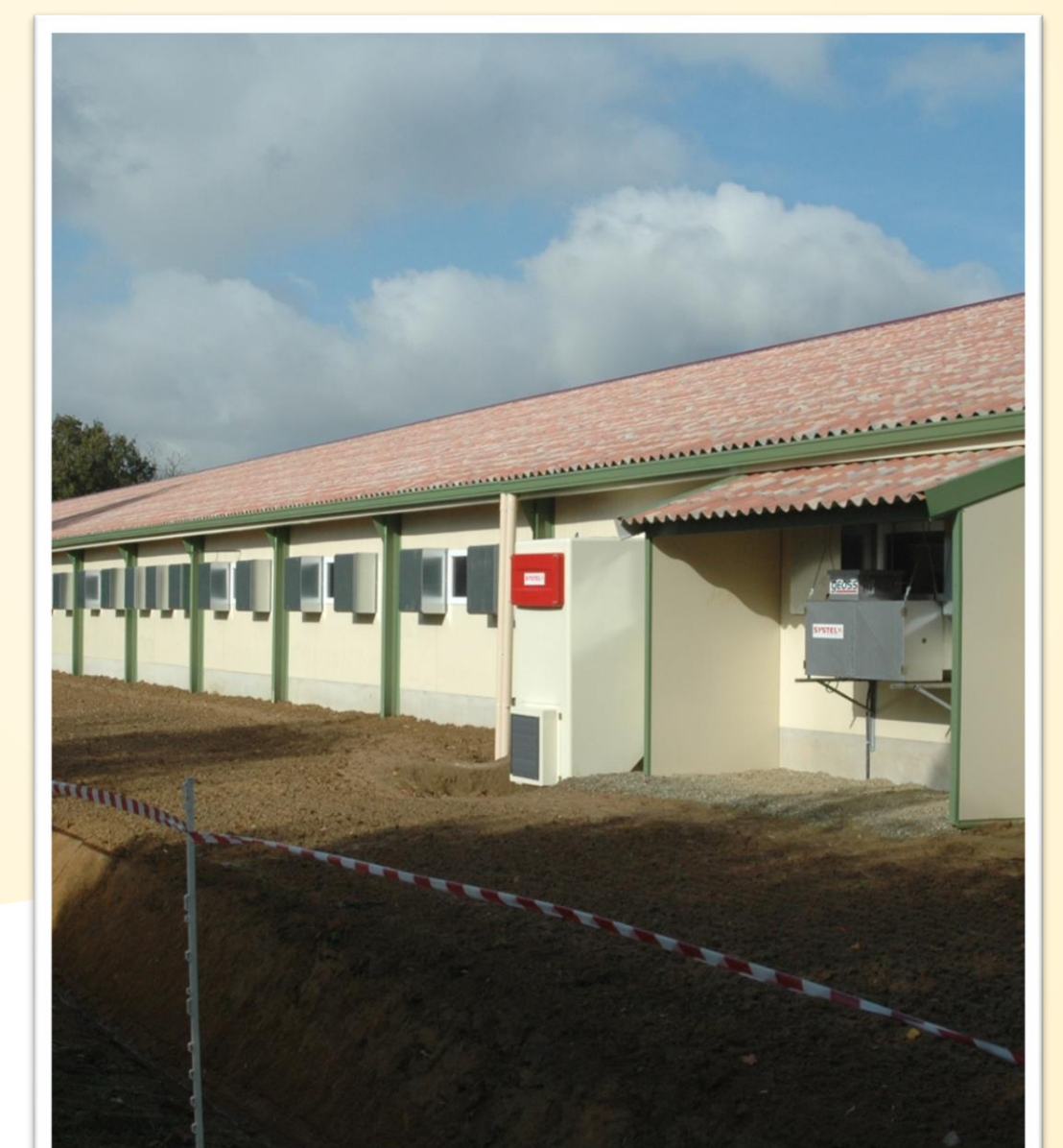
Echangeur et canon extérieur Crédit photo : CRAPL
