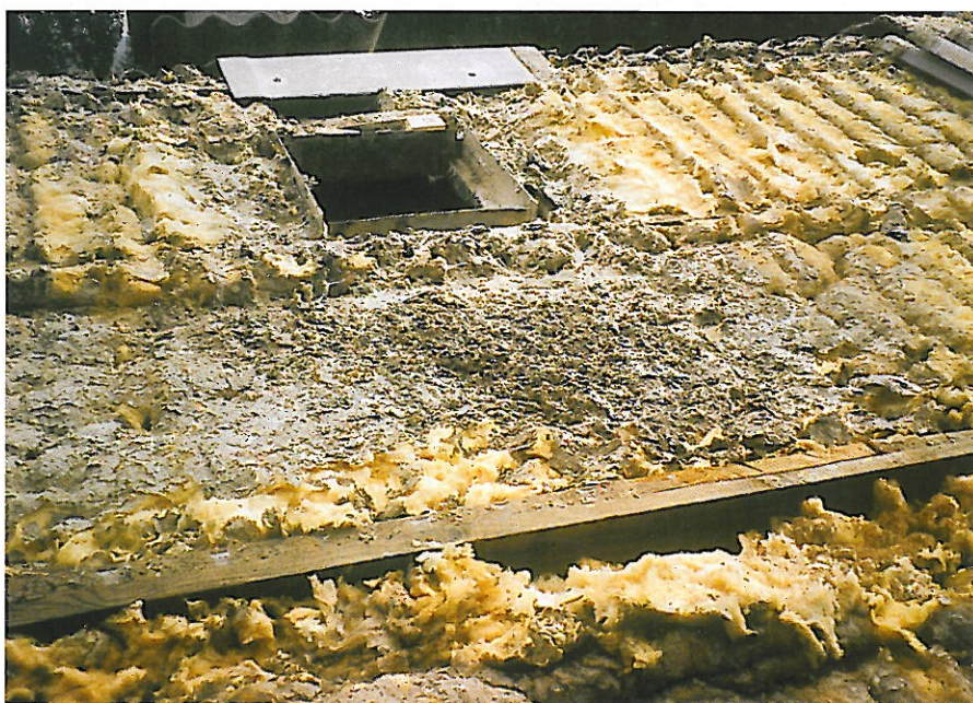
L'introduction d'air chaud et humide dans la sous-toiture provoque des dommages importants au niveau de l'isolant et des pannes.
