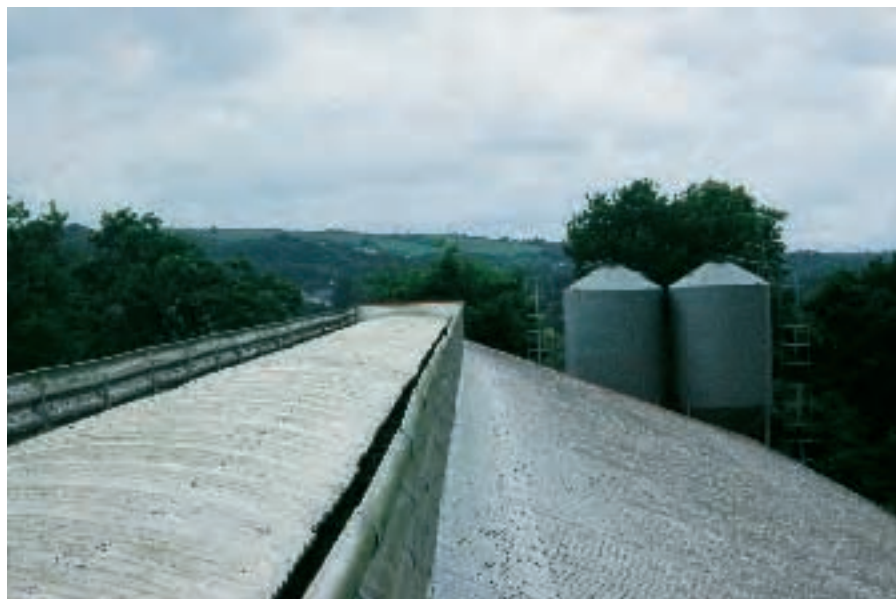
Un lanterneau mal dimensionné ne permet pas une ventilation efficace
