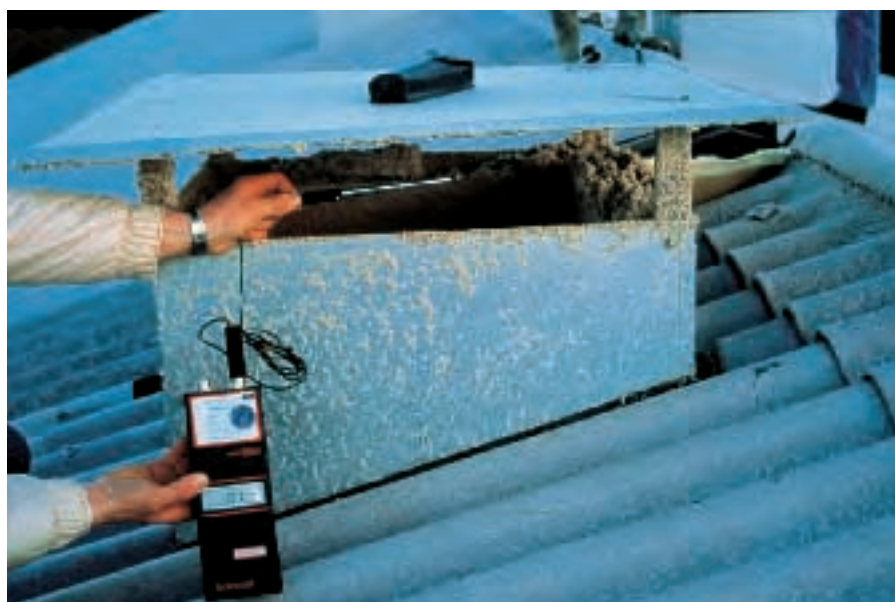
Mesure des vitesses d'air aux ventilateurs pour déterminer les débits réels.
