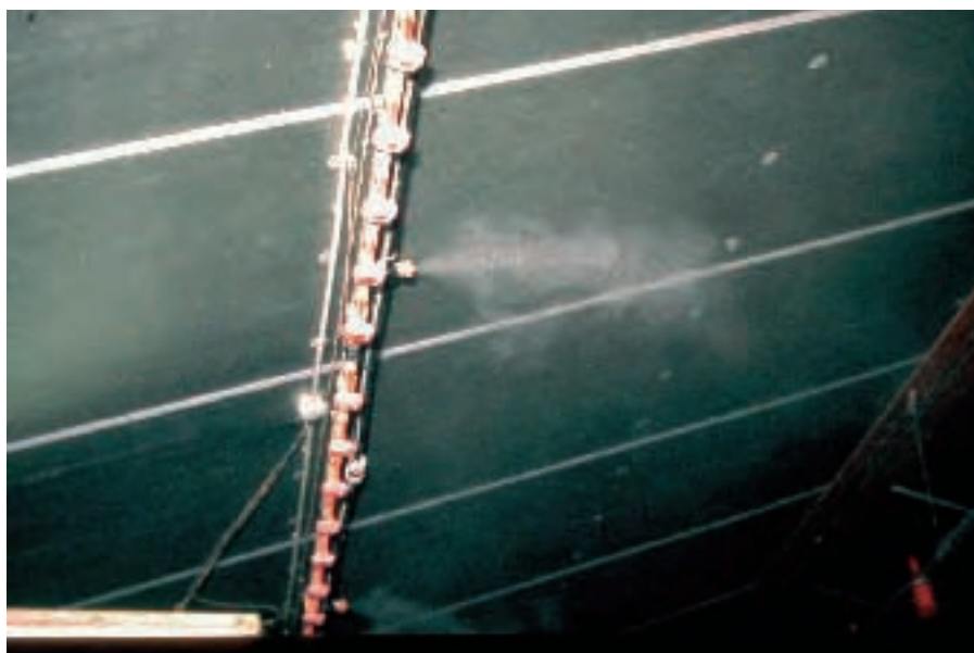
Pour dimensionner un système de refroidissement, il faut avant tout déterminer la quantité d'eau à évaporer
