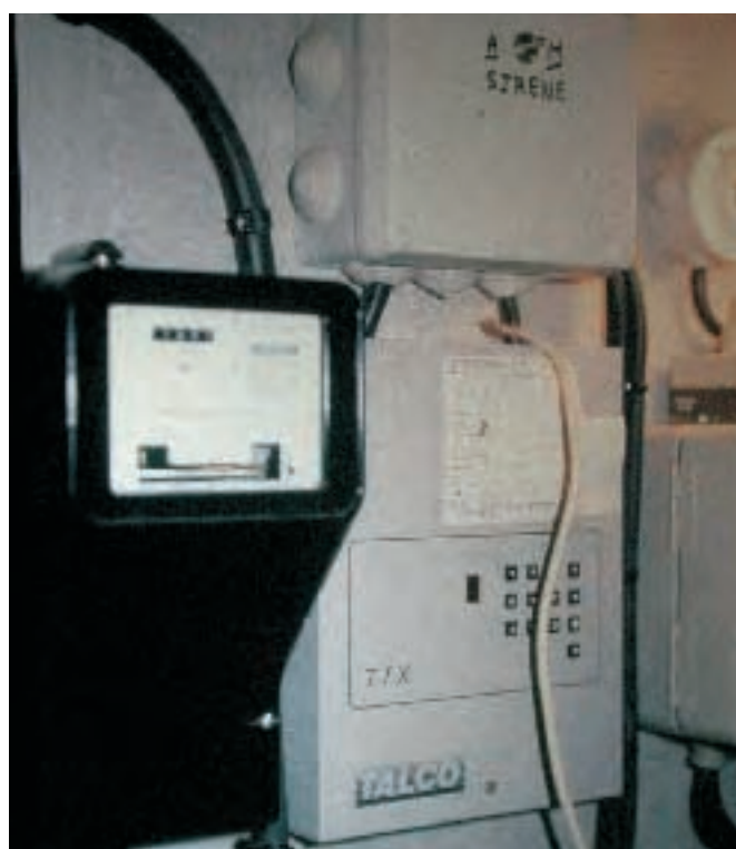
Une alarme fonctionnelle permet de réagir rapidement - attention à son paramétrage
