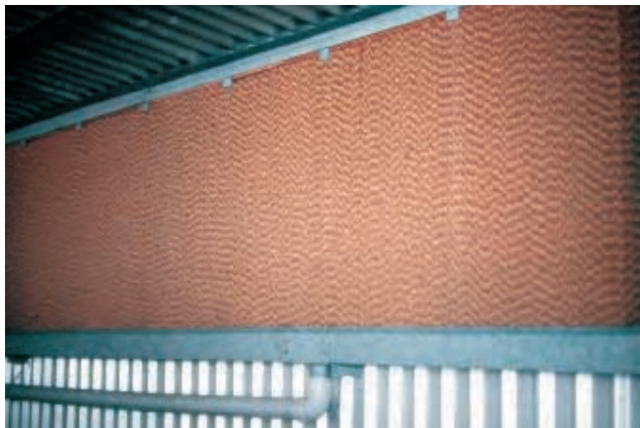
Un filtre humide ou pad-cooling
