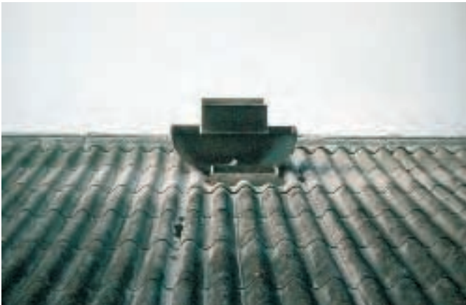
Bâtiments dynamiques à extraction haute : il arrive souvent que les cheminées soient mal dimensionnées et réduisent les débits de ventilation
