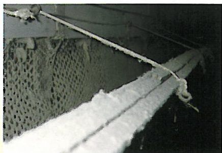
Les poussières s'accumulent aux entrées d'air
