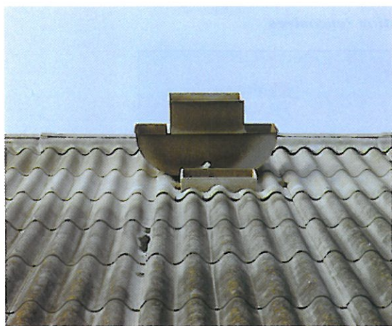
Des débits de ventilation insuffisants...
