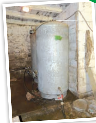
Une cuve tampon pour assurer l'efficacité du traitement du chlore.
