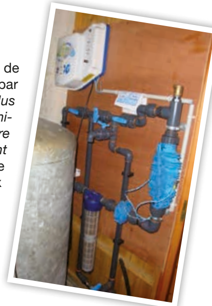
Système de traitement par électrolyse.
