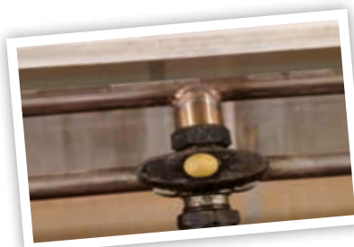
Après 16 ans, les canalisations de gaz en inox n'ont pas bougé.
