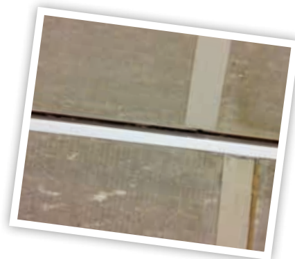
Les Z en inox sous les trappes limitent les dégradations de l'isolant.
