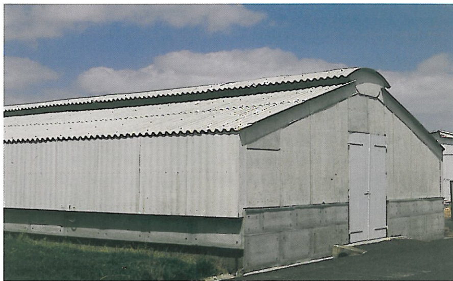
Les interventions sur des bâtiments contenant de l'amiante sont elles aussi réglementées.
