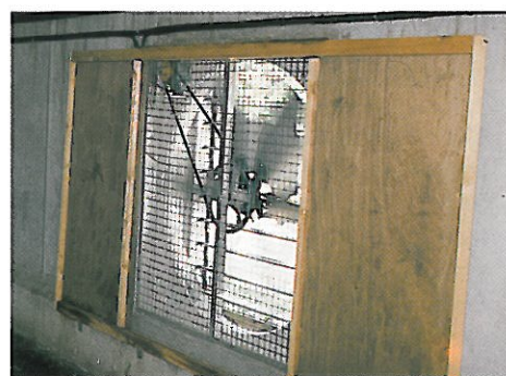
Exemple de turbine à gros débit
