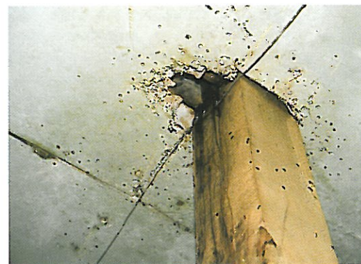
Dégradation de l'isolant de toiture due aux ténébrions
