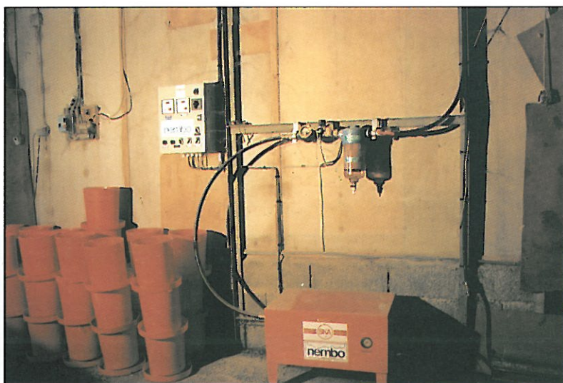
Système de pulvérisation NEMBO de SKA. Vue de la pompe, du système de filtration et de la régulation.
