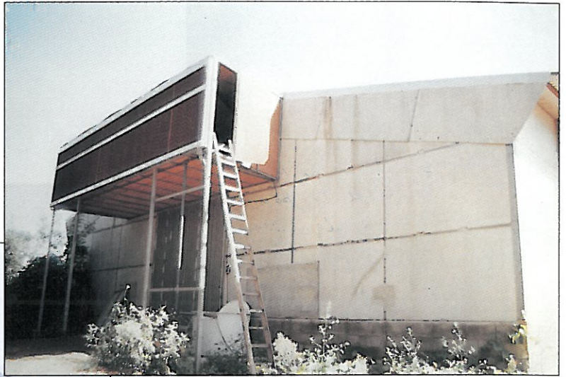
PAD FILCLAIR. Vue du caisson de traitement extérieur.
